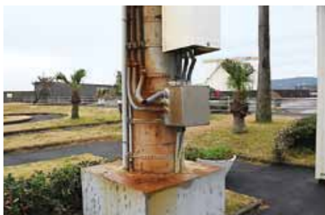
▲老朽化した屋外拡声子局(スピーカー)の柱 ※根本部分は修繕済
