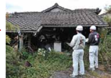
▲昨年度制定した「空き家等の適正管理に関する条例」。昨年度は本条例の「空き家の危険度判定」に基づき、約90棟の空き家の実態調査を行いました。
