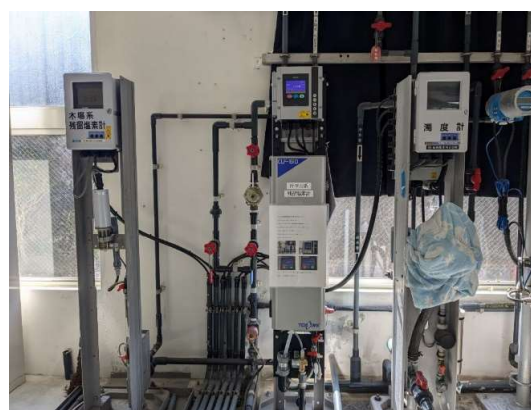
深浦水源地濁度計・残塩計
