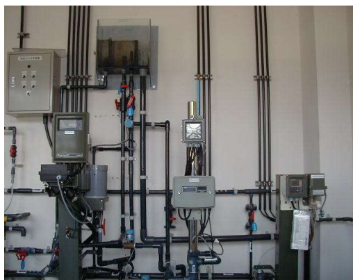
金山浄水場濁度計・PH計・残塩計
