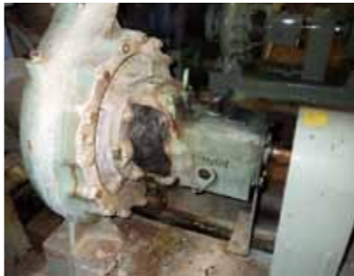
▲設置後20年経過した装置
