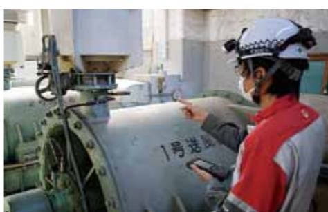
▲日々点検を行い、設備の状況を把握している
