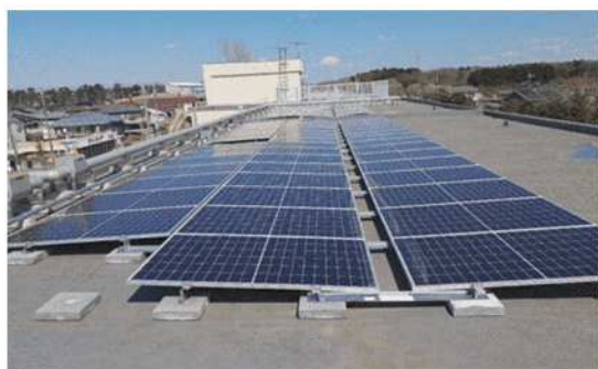
太陽光パネル
